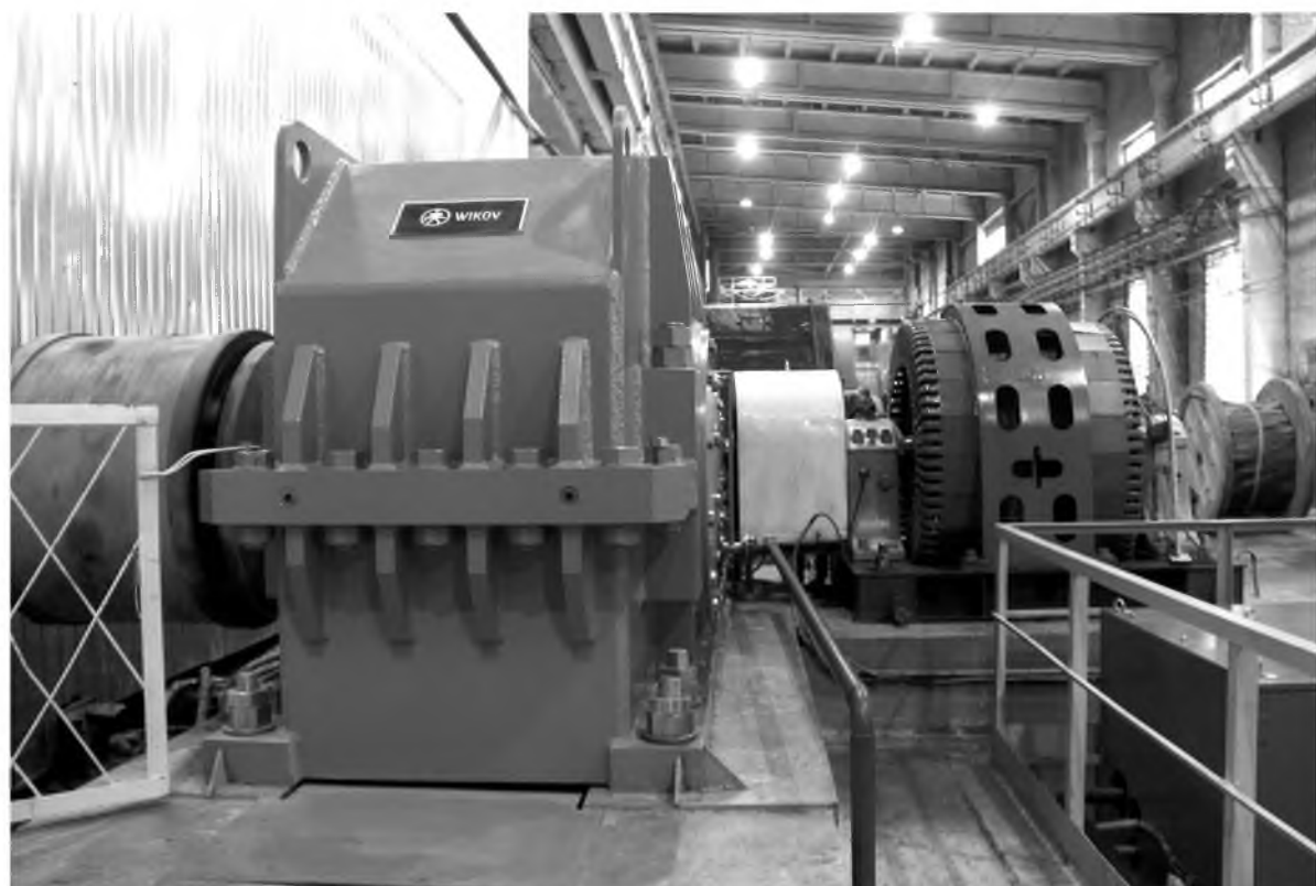
В 2020 году в цехе «Помол» установлен современный редуктор
