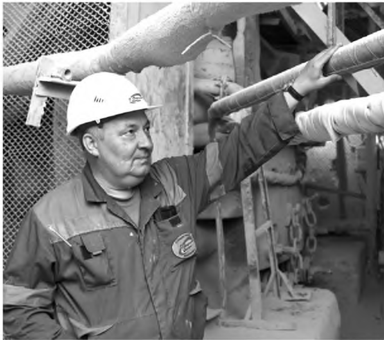
Нагревательный элемент протянут вдоль всего трубопровода
